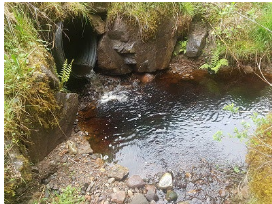
Fig. 3.1.3.2 Culvert Obstacle AT02
